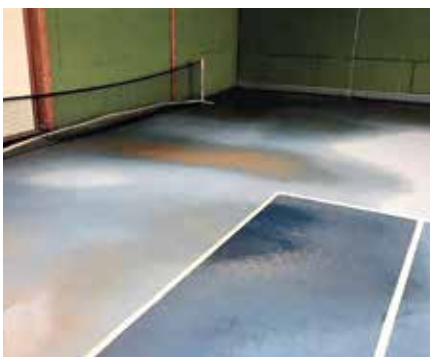
Wasserschaden Blaue Halle
